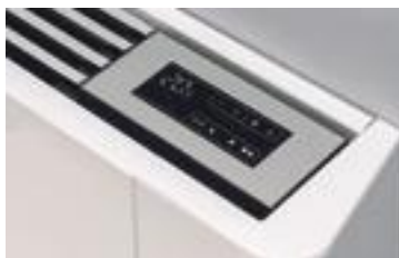
Vgrajen napredni termostat.
